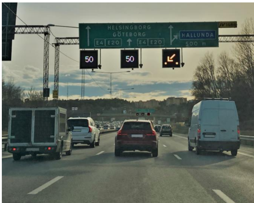
Figur 2. En vägportal som tillhör trafikledningssystemet. Rekommenderade hastigheter samt pil visas i körfältssignaler..
