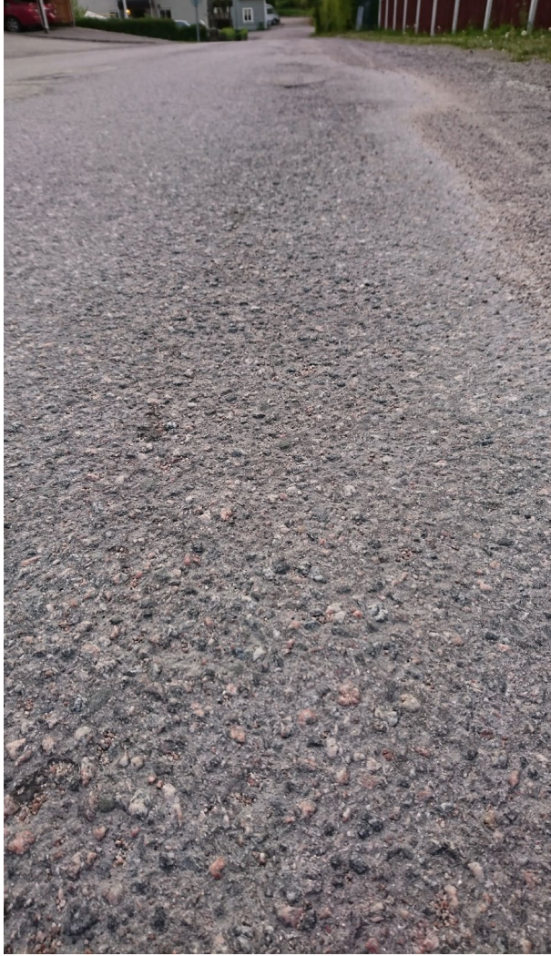
Gammal torr beläggning med materialförluster.
