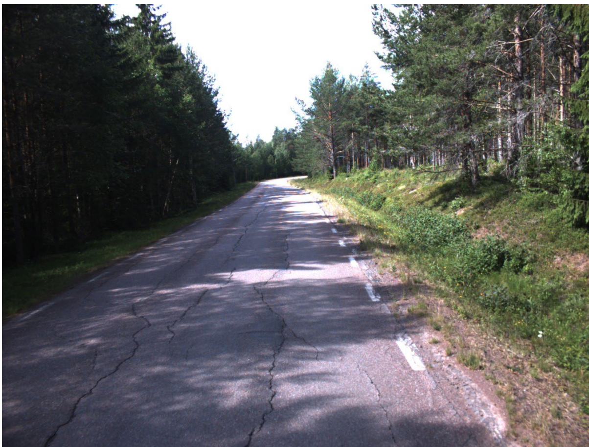
Figur 22 Väg 1002 i Dalarna. En Y1B med åldrad yta, ytskador och tjalsprickor. Foto: Automatiskt taget från mätbil.
