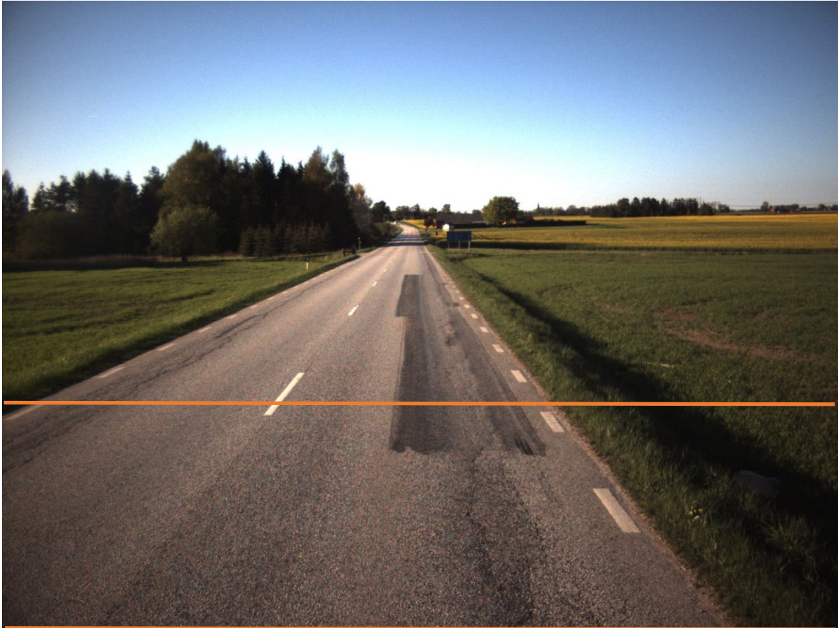
Figur 9 Översiktsbild av väg 108. Området mellan de parallella linjerna motsvarar nedanstående analys av sprickor. Foto: Automatiskt taget från mätbil.
