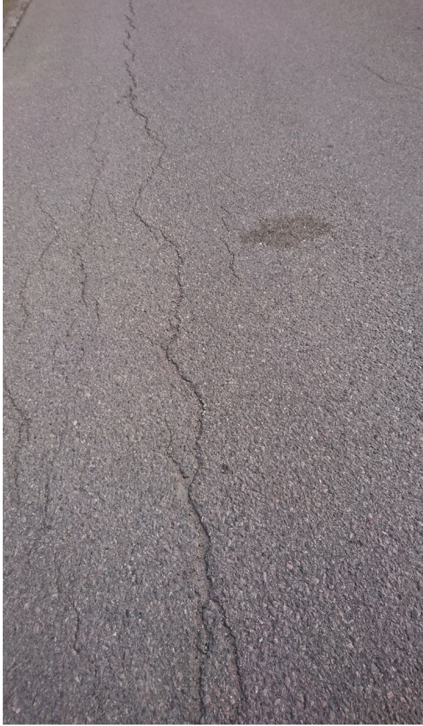
Längsgående sprickor i hjulspår.
