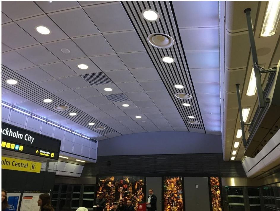
Figur 11. Bild över plattformsrummet. I taket sitter mikroperforerade kassetter
