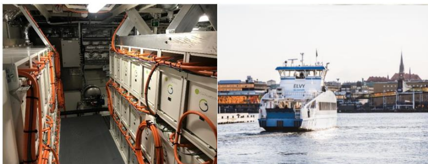
Figur 4 Elhybridfärjan Elvy strax före trafikstart hösten 2019. Bilden visar batteriinstallation och färjan vid dess fasta plats på Lindholmen. Foto IVL respektive Västtrafik.
