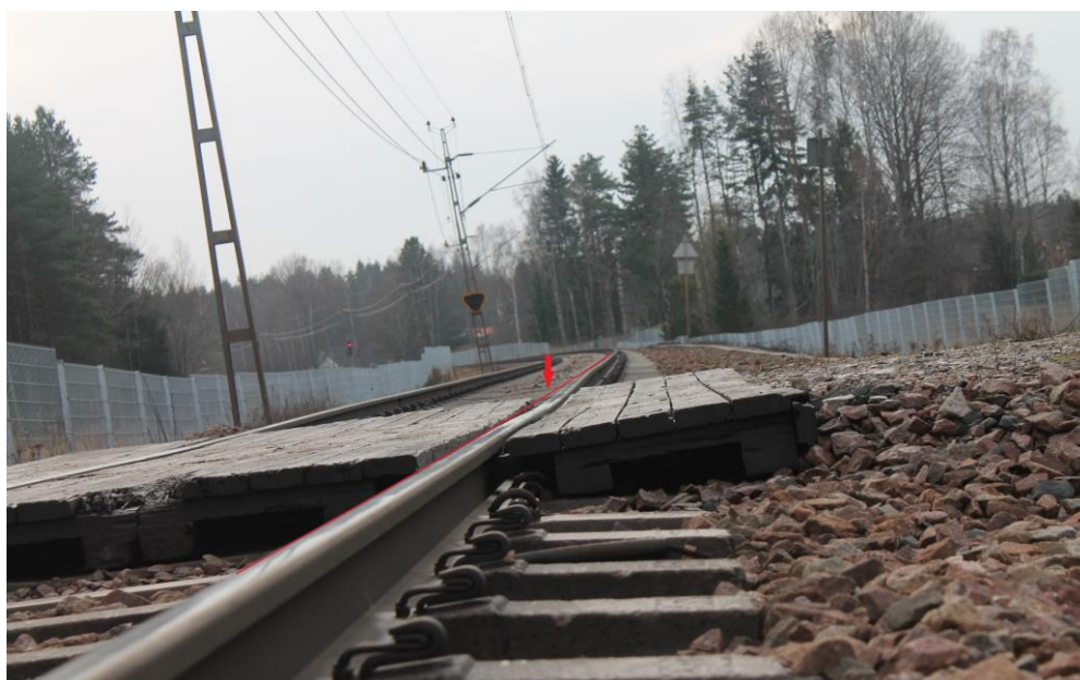
Figur 16. Detekterad avvikelse i plankorsning, nedböjning av räl.
