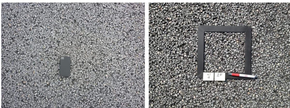
Bild 2. Provsträcka 4 med två förseglingar av Fog Seal (vänster 2012, höger 2013).
