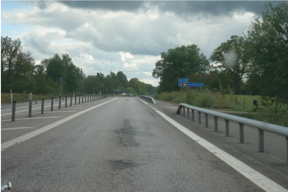
Figur 14 Cykelbana (utanför räcket till höger i bild) längs väg 23 mellan Ballingslöv och Hästveda. Foto: Jutta Pauna-Gren, Ramböll.
